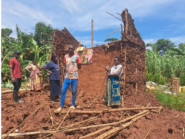
Die Sonne lacht, als hätte es diesen Tornado nicht gegeben. Die Schäden sind groß an Häusern, Feldern und dem Toilettenhaus der Buleega Grundschule
